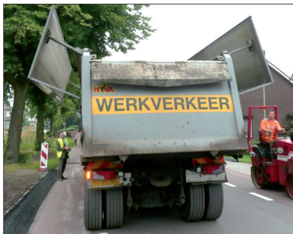
Figuur 1.3 – Vrachtwagen met isolerende afdekkleppen
