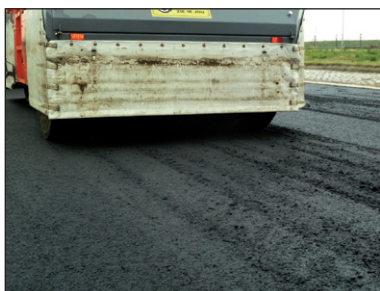
Figuur 4.11 – Losrukken van asfalt door een bandenwals met te koude banden
