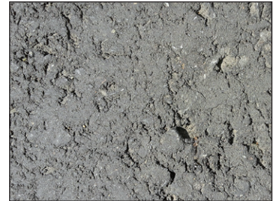
Figuur 7.2 – Haarscheurvorming in asfalt dat bij een te lage temperatuur is verdicht
